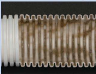
排水ホース内部の汚れ
